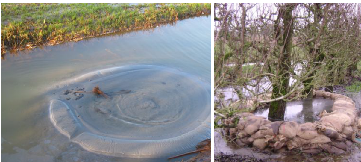
Foto: Wellen in het rivierengebied, veroorzaakt door piping, bron Waterschap Rivierenland.
