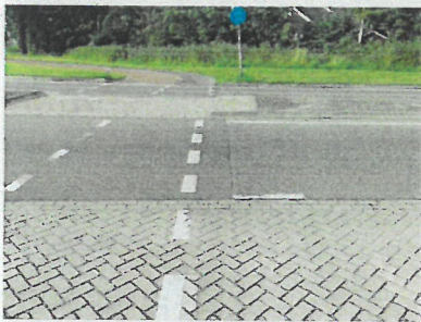
Figuur 2.2+ 3: asfaltscheidingen rondom de rotonde
