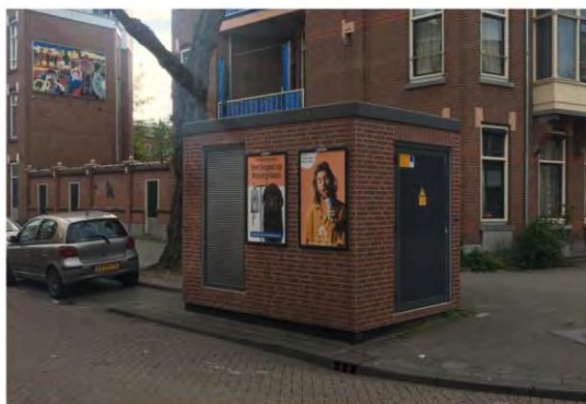
Figuur 12 - Voorbeeld van een Middenspanningsruimte
