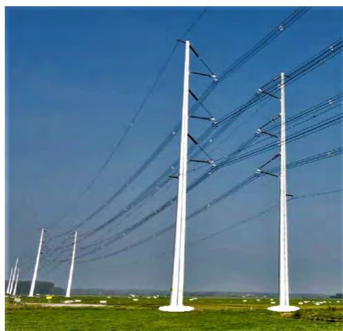
Figuur 28 - Twee circuits 380 kV
