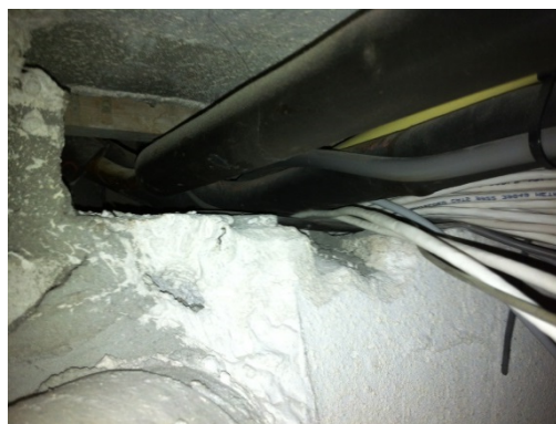
Afbeelding 3: Foutieve doorvoering diverse kabels en leidingen
