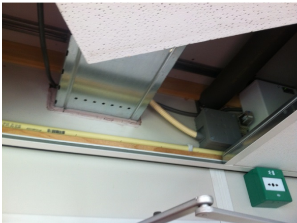
Afbeelding 2: Foutieve uitvoering kabelgoot boven een deur
