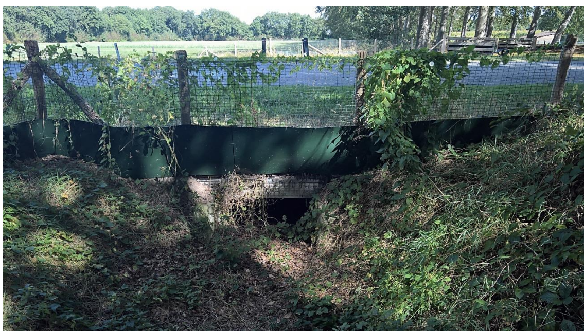
Raster en faunatunnel onder de Rucphenseweg tussen de Lange Maten en De Moeren
